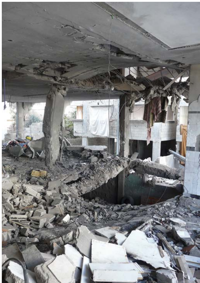
Das Haus der Familie Abu 'Aisha, das am 5. Januar 2009 von Bomben getroffen wurde. © Amnesty
